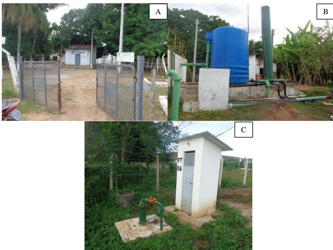
Figura 6 – Sistema de Captação e Tratamento D'água. (A) Instalações onde se localiza o poço amazonas; (B) ETA; (C) Um dos cinco poços tubulares.
