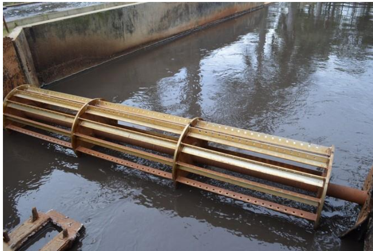
Figura 3 – Aerador Tipo Gaiola Fonte: Adaptado de LEITE, 2016.
